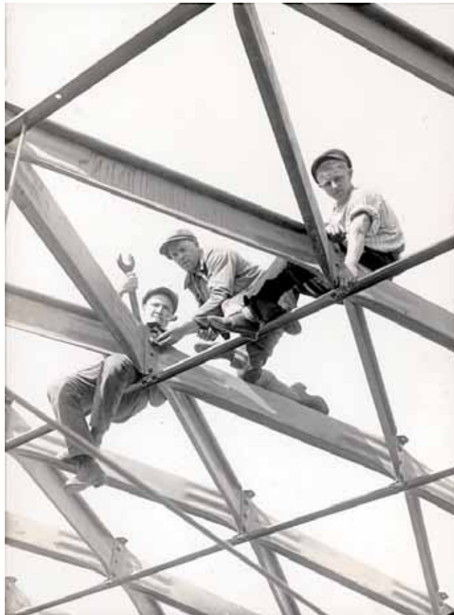
Emil Theis, Arbeiter bei der Montage der Turnhalle der Grundschule Dessau-Ziebigk in Junkers-Stahllamellenbauweise, 1928
